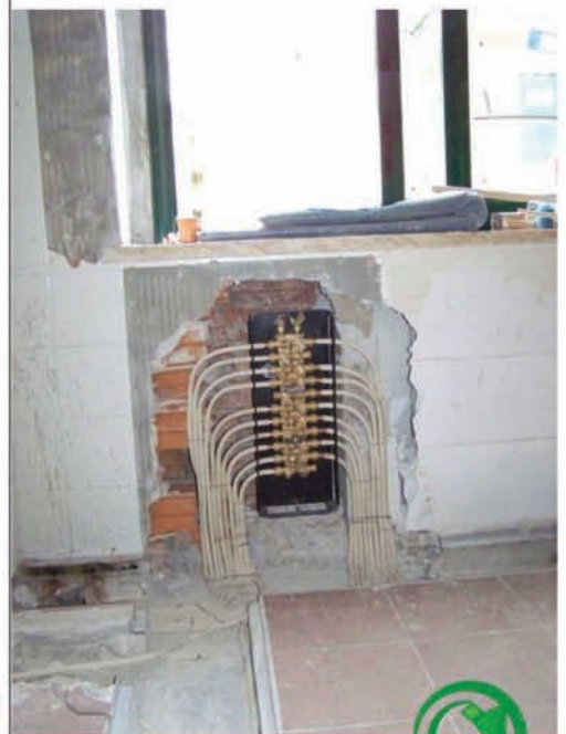
La centralina di comando dell'impianto di riscaldamento
