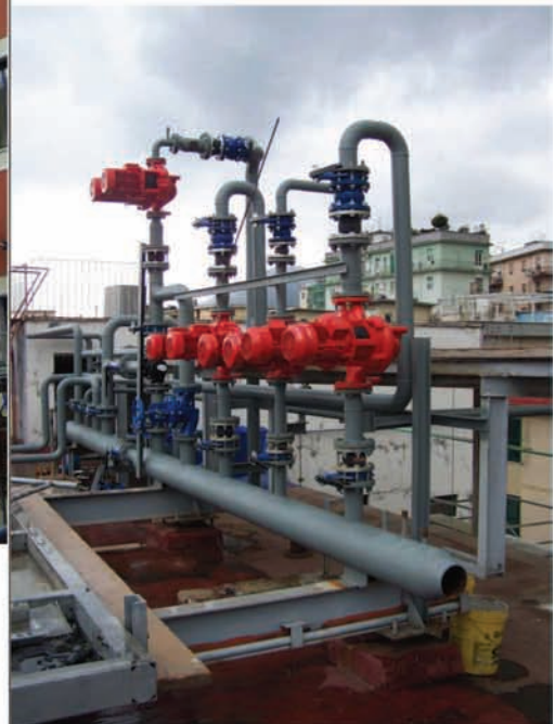
Particolare della centrale termoelettrica installata sul terrazzo di copertura dell'edificio
